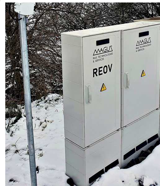
Řídicí rozvaděč REOV a stožár s čidly u trati
