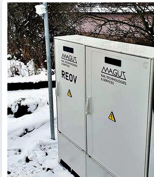
Řídicí rozvaděče REOV – boční pohled se stožárem s čidly
